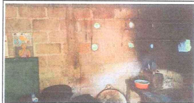
PAREDES DE COCINA CON NECESIDAD DE MEJORAMIENTO
