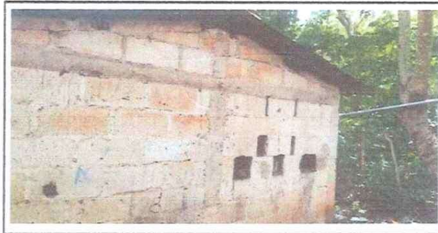
PAREDES DE COCINA CON NECESIDAD DE MEJORAMIENTO
