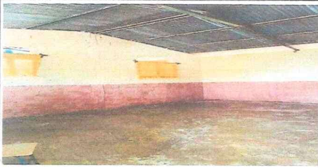
TECHO EN MAL ESTADO
