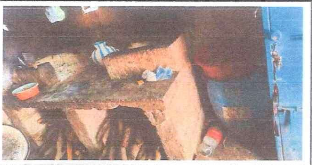
POLLETON EN MAL ESTADO
