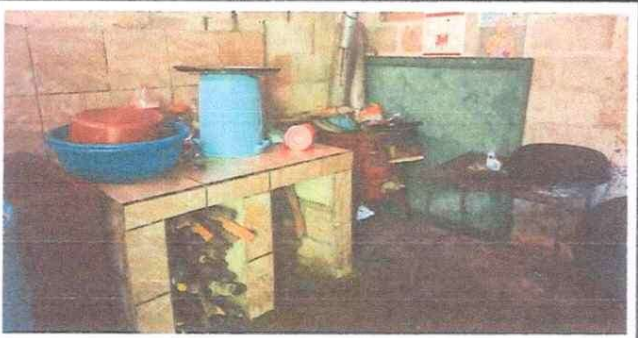
COCINA CON NECESIDAD DE REMOZAMIENTO
