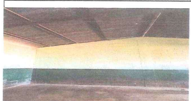
TECHO EN MAL ESTADO
