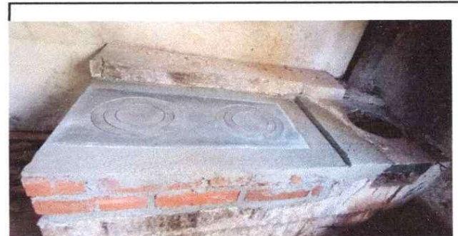
Foto 6: Sustitución de estufa rural
