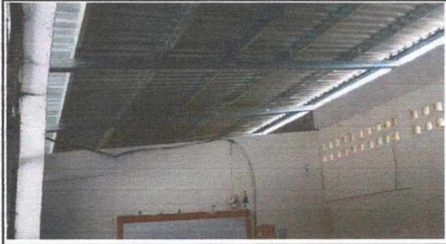
Foto 2: INSTALACIÓN DE TECHO CON ESTRUCTURA METALICA Y LAMINA TROQUELADA EN MODULO DE AULAS
