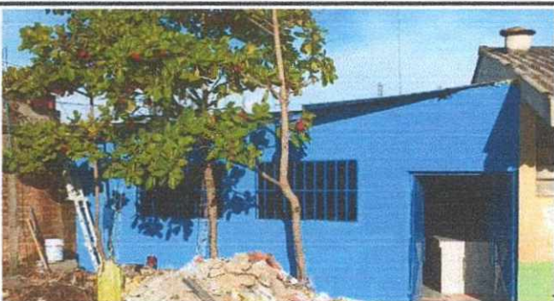
Foto 5: REPELLO, CERNIDO Y PINTURA EN MUROS INTERIORES Y EXTERIORES, MEJORAMIENTO DE PILA, INSTALACIÓN DE PUERTA Y SUSTITUCIÓN DE TORTA DE CONCRETO POR PISO CEMENTADO EN AREA DE
