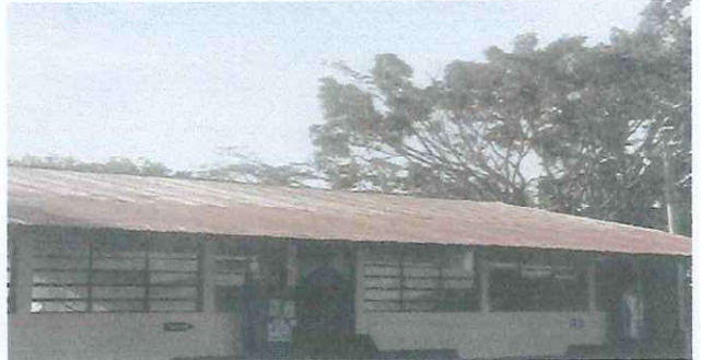
Foto 2: Techo a remozar con pintura dos aulas , ala Norte.
