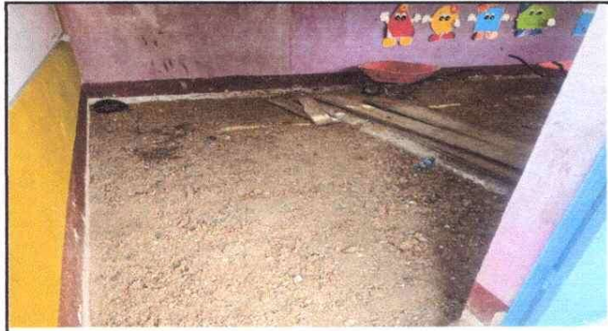
MEJORAMIENTO DE TORTA EN MAL ESTADO
