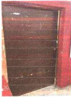
Foto 1: REFORZAMIENTO DE PUERTA CON PASADOR PARA RESGUARDO DE BIENES Y DOCUMENTOS
