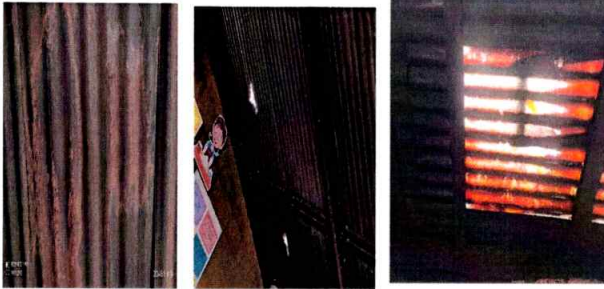
Foto1: SUSTITUCION DE CUBIERTA DE LAMINA: en toda la cocina debido a que esta en mal estado.
