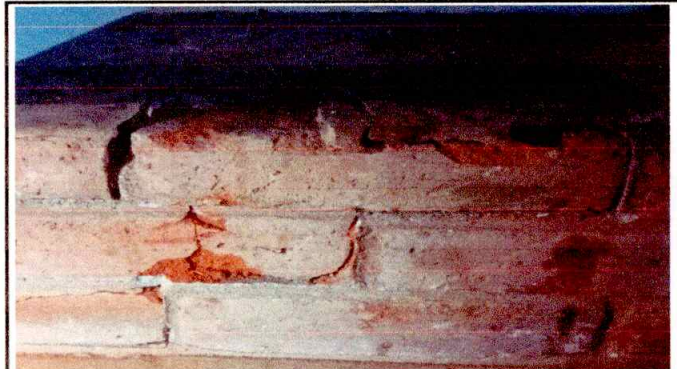
Foto10: estufas rurales en mal estado.
