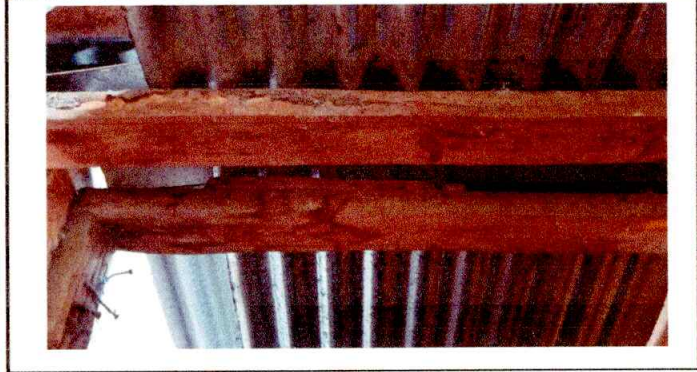
FOTO2: Se observan estructura en mal estado.
