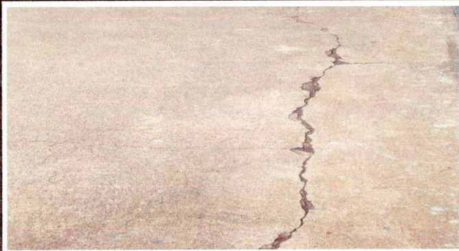
Foto: 7 Se evidencia Losa de patio del area de párvuos en mal estado
