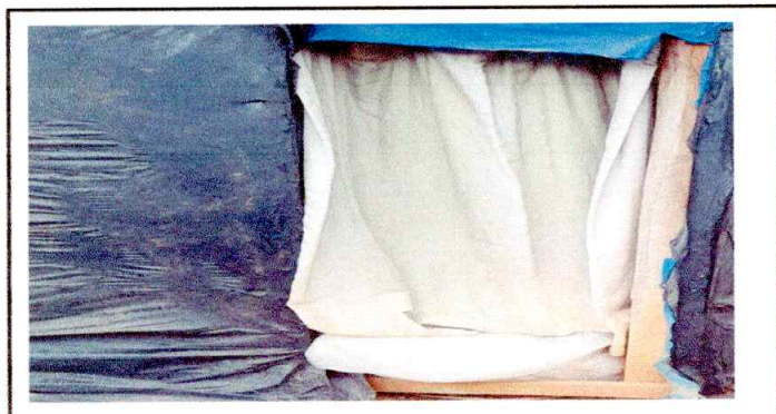
Foto3: Se observa puerta de párvuos improvisada
