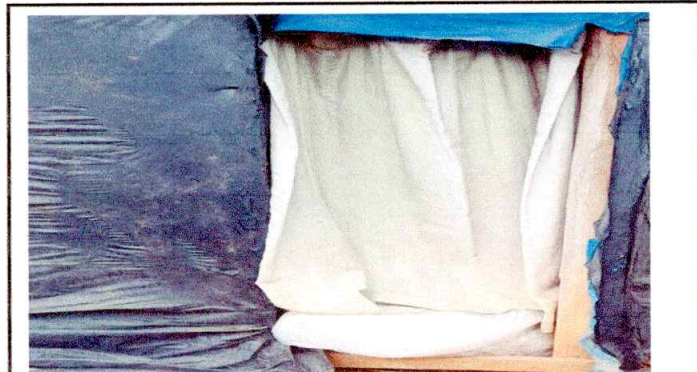
FOTO4: Se observan paredes del baño de parvulos improvisadas.
