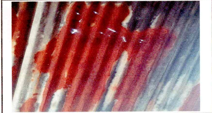
Foto1: Se Observa lámina en mal estado.
