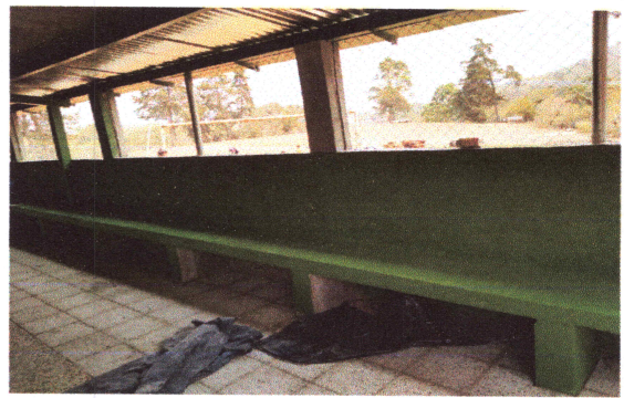
FOTO 4: Pintura de una parte del muro interior y exterior de la escuela en proceso.
