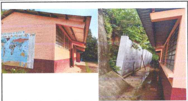
Foto1: En las fotografías se aprecia la necesidad de colocar canales Iluviales en la lamina de dos salones de clases, dirección y cocina, debido a que el agua se reposa en el patio de la escuela y en la parte de atrás.
