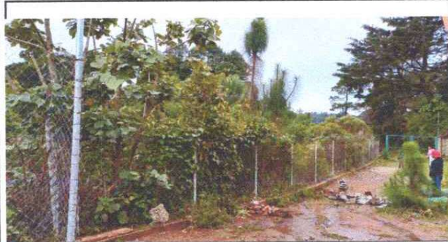
Foto 3: el cerco perimetral se esta hundiendo, por lo tanto, se necesita reparación de 25 metros.
