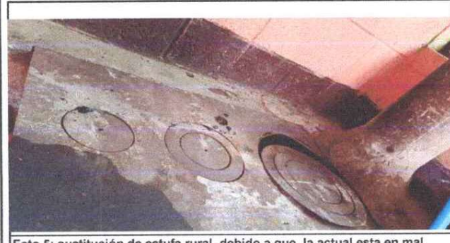
Foto 5: sustitución de estufa rural, debido a que, la actual esta en mal estado.
