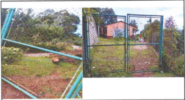
Foto 2: Se aprecia la necesidad de reparación del portón por que la malla esta rota, lo cual permite que personas ajenas a la institución entren a consumir bebidas alcohólicas.
