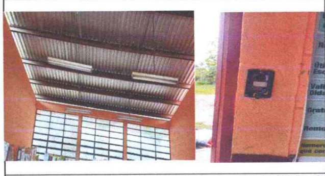
Foto 4: Se observa la necesidad del sustituir todo el cableado eléctrico, de dos aulas, dirección y cocina.
