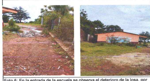
Foto 6: En la entrada de la escuela se observa el deterioro de la losa, por lo tanto, es necesaria la sustitución, incluyendo base, fundición y acabado.
