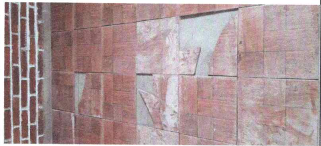
Foto 2: piso de las aulas deteriorado
