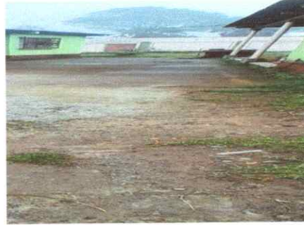
Foto 2: Reparación de losa de patio, ya que se encuentra muy dañada
