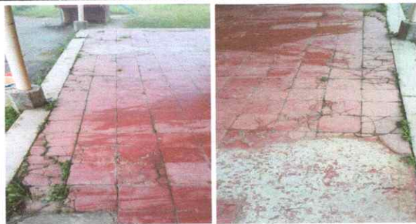
Foto 3: Sustitución de piso de cocina ya que se encuentra muy quebrado
