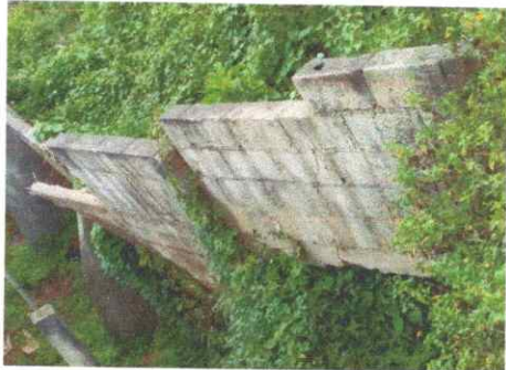
Foto 1: Muro en mal estado
