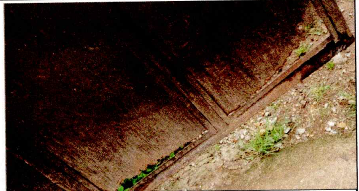
Foto 2: PUERTAS Parte baja deteriorada
