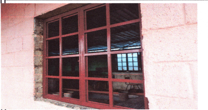
Foto 1: Instalación de ventana. Falta el vidrio
