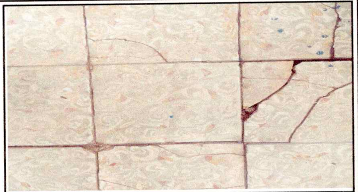
FOTO 2: Se observa piso en mal estado
