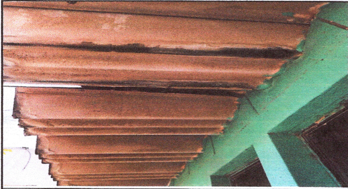
Foto 1: Sustrucción de Lámina
