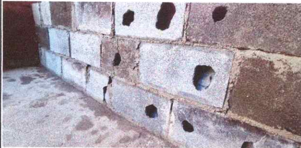
Foto 7: Sustrucción de pared que divide la cocina con aulas (al norte del centro educativo)
