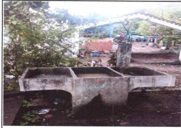
Foto 10: Reparación o sustitucion de area de cocina (estufas rurales, pilas, ventanas, pueetas, chimineas etc)
