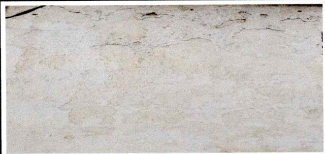
Foto 6: Se observa repello en mal estado (área cocina)
