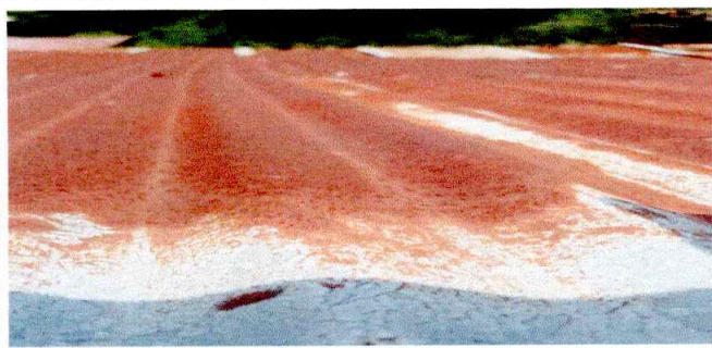
Foto 1: Se observa lámina en mal estado
