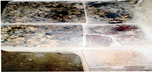
Foto 3: Se observa piso en mal estado (área cocina)
