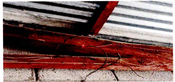
Foto 4: Se observa sistema eléctrico en mal estado (área de cocina)
