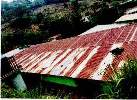
Foto 1: Techo en mal estado
