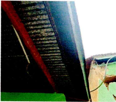
Foto 3: Canales en mal estado
