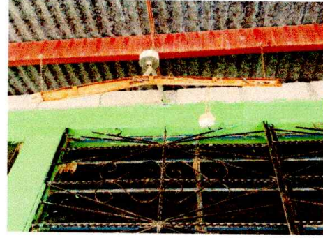
Foto 8: Sistema Eléctrico en mal estado
