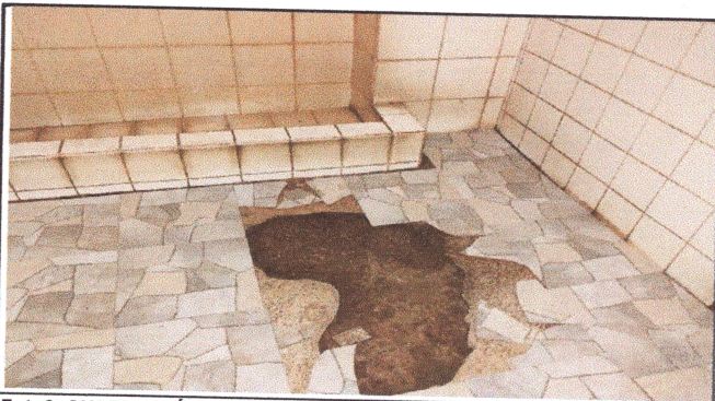
Foto3: SUSTITUCIÓN DE PISO MODULO DE SANITARIOS DE NIÑOS, DE NIÑAS, VESTIDORES Y PASILLO DE PILAS.
