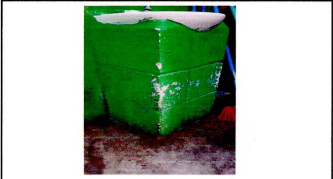
Foto 2: sustitucion lavamanos en mal estado
