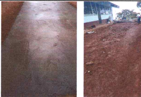
Foto 5: Evidencia de reparación de losa de patio
