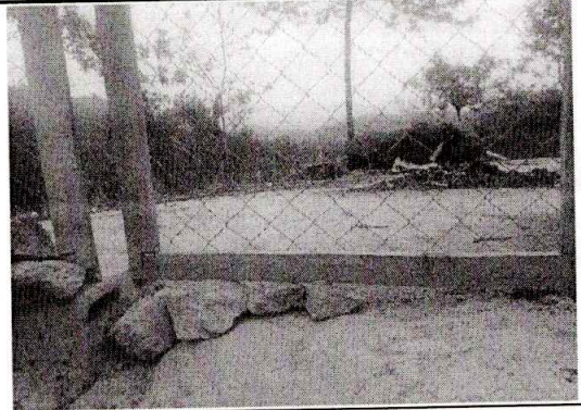
Foto 2: PORTÓN EN MAL ESTADO
