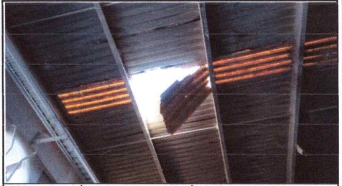
FOTO 2: RENGLÓN NO. 2, SE SUSTITUIRÁ LA ESTRUCTURA DE DE TECHO EN EL ÁREA DE COCINA DE LA ESCUELA EN 80 MTS. CUADRADOS,
