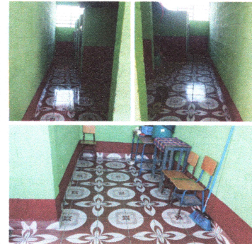
FOTO 2: Sustitución de la torta de cemento por piso, en la cocina, sanitarios y pasillos.
