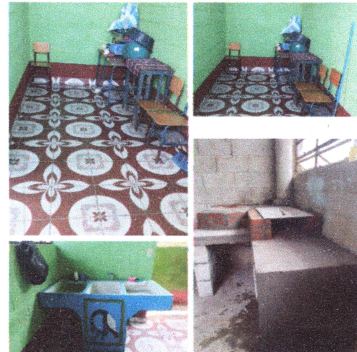
FOTO 8: Sustitución del área de la cocina, porque no se encuentra en las condiciones adecuadas para la preparación de los alimentos.
