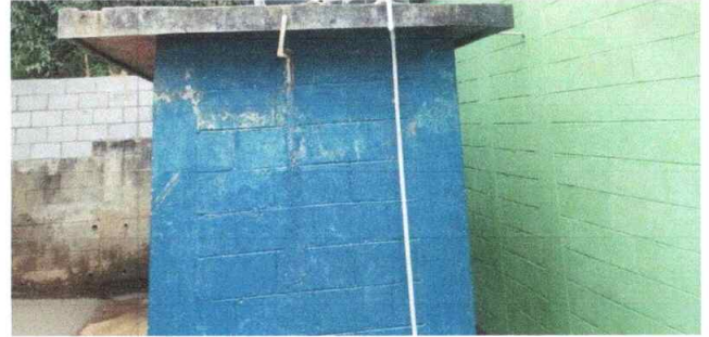
Foto 2: Red de Agua Potable para baños
