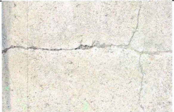
Foto 4: losa de patio en mal estado
