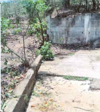
Foto 3: Muro Perimetral en mal estado
