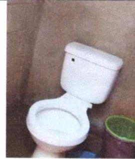
Foto 4: servicios sanitarios y sus accesorios
