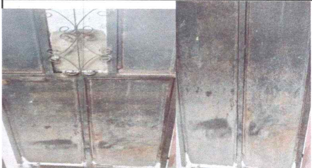
Foto 2: mantenimiento a porton (sustitucion por daños y oxido)
