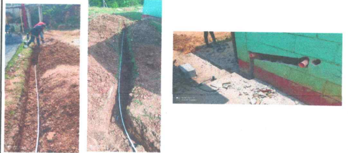
FOTO 2: Reparación de red de drenajes y agua potable en el área de cocina y sanitarios
