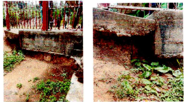
Foto4: MURO DE CONTENCIÓN DETEREORADO
