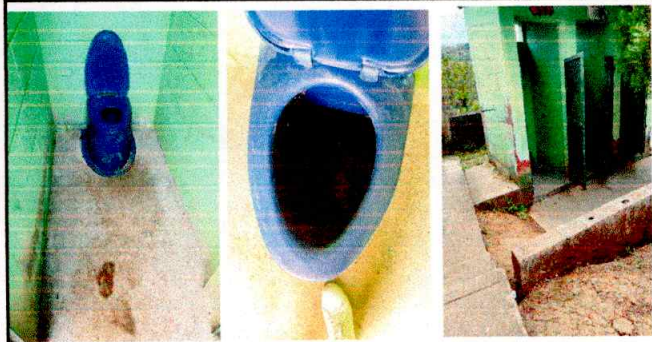
Foto1: SANITARIOS EN DETERIORO Y COLAPSADOS
