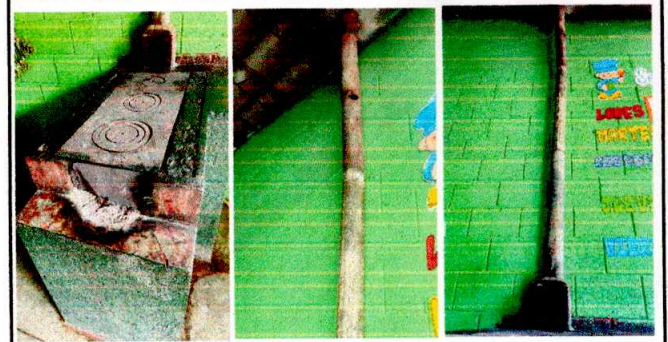
FOTO 2: COCINA EN MAL ESTADO
