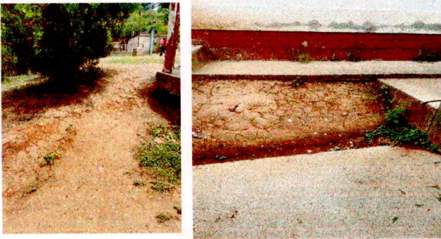
Foto1: LOSA DE PATIO DESTRUIDA
