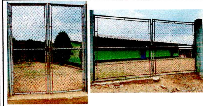
Foto3: PORTONES EN DETERIORO
