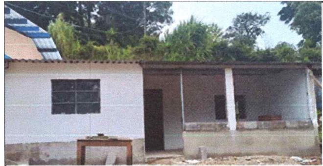
FOTO 8: REPARACION DE REPELLO Y CERNIDO DE PAREDES: Aplicación de repello en area de cocina. (renglón 8)
