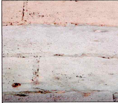
FOTO 8: REPARACION DE REPELLO Y CERNIDO DE PAREDES: Aplicación de repello en area de cocina. (renglón 8)
