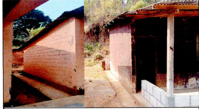
Foto4: PINTURA EN MUROS INTERIOR Y EXTERIOR: Aplicación de pintura en paredes del aula y de la cocina interna y externa. (renglon 4)
