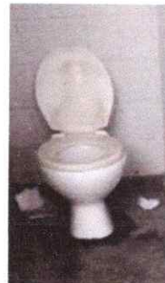
Foto 4: SERVICIOS SANITARIOS Y SUS ACCESORIOS
