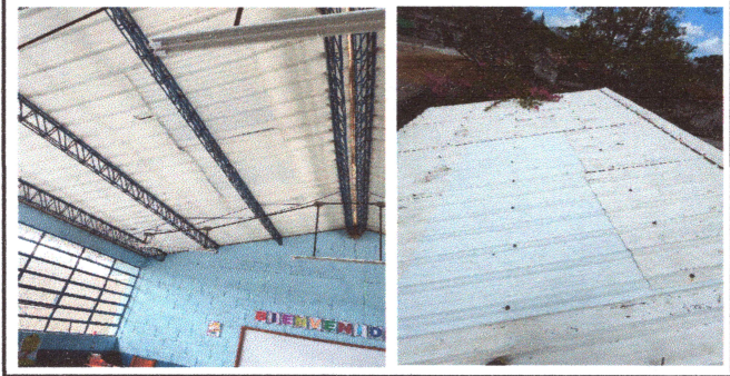
Foto: Láminas dañadas.
