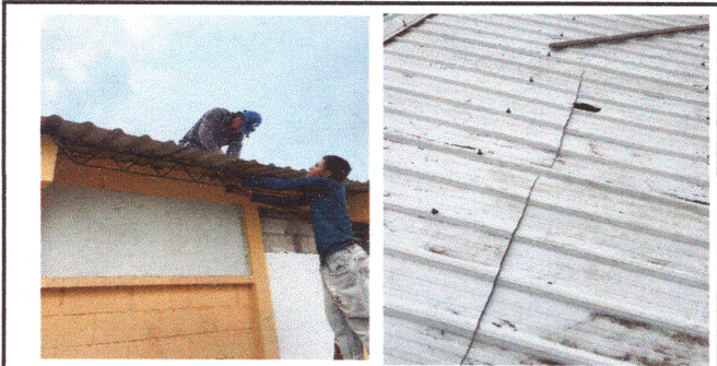
Foto: Láminas dañadas.
