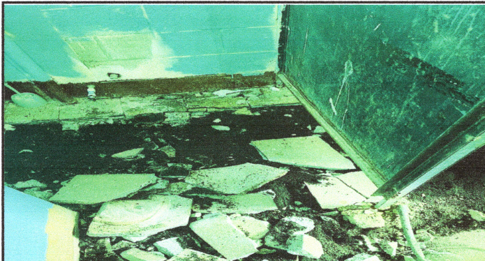
Foto3: SANITARIOS Y DRENAJES Y TUBERIA DE AGUA DE 3 MODULOS. VIVIENDAS DE ESTUDIANTES.
