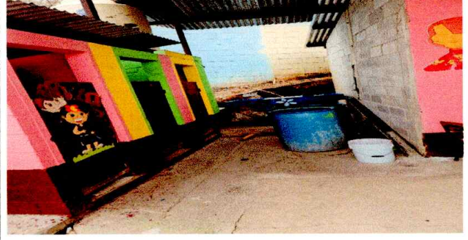
Foto 8: Tubería de drenaje en área de baños y pila dañada
