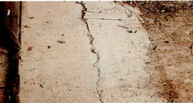
Foto 9: Losa de entrada y patio en mal estado
