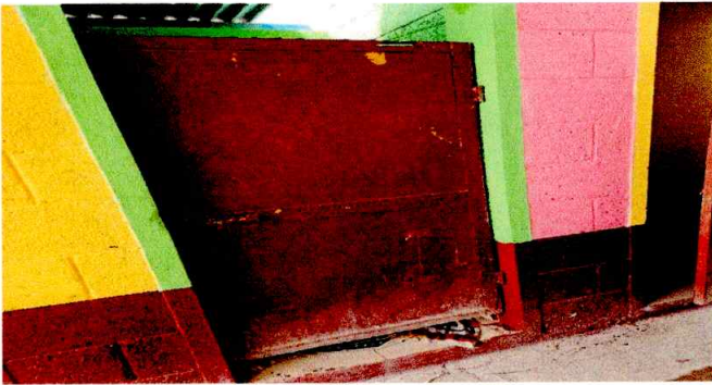
Foto 3: Puertas de sanitarios en mal estado
