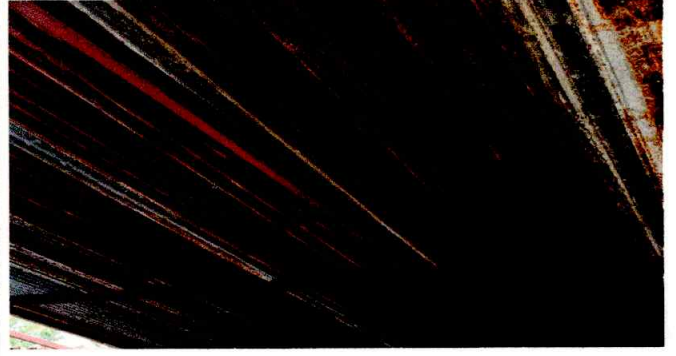
Foto 2: Techo de cocina en mal estado
