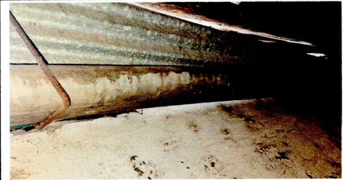
Foto 6: Canal en mal estado
