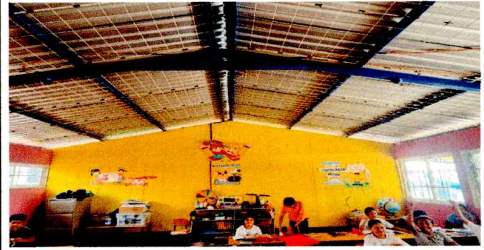
Foto 10: Sistema eléctrico en mal estado
