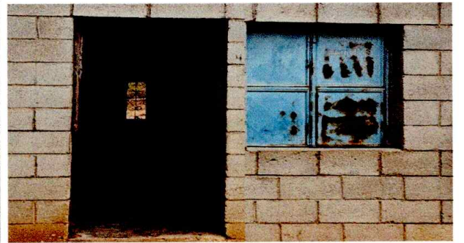
Foto 4: Ventana y puerta de cocina en mal estado
