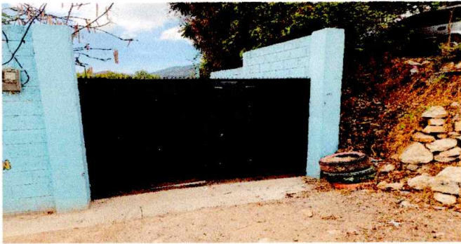
Foto 7: Portón en mal estado
