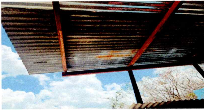
Foto 1: Techo de baños y lavamanos en mal estado
