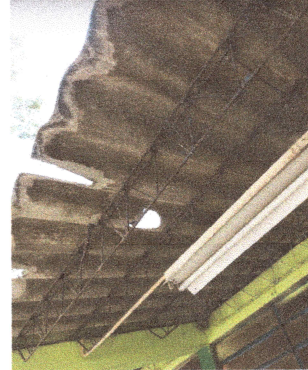
FOTO 2: Levantar cubierta de lamina tipo duralita a 432 mts2, pintar estructura metalica, reforzar la estructura metalica y colocar cubierta de lamina nueva tipo acanalada.
