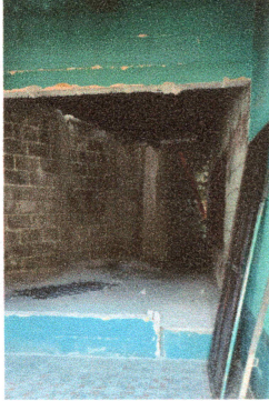
Foto 1: La pared de la cocina se encontraba en mal estado.
