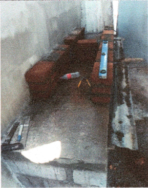
Foto 3: Se cambio la plancha que se utiliza en la cocina.
