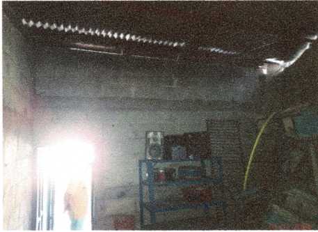
Foto1: Se ampliará la cocina, levantar cubierta de lamina, pintar estructura, pintar lamina, bajar el nivel del suelo, repellar, pintar, instalar pila elaborar gabinetes prefabricados.
