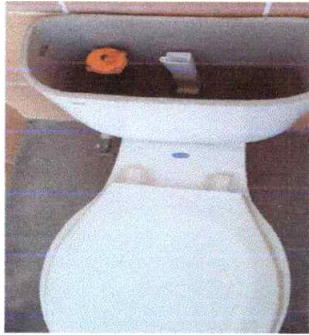
Foto 3: SERVICIOS SANITARIOS Y SUS ACCESORIOS (MANTENIMIENTO)
