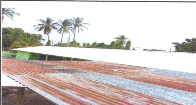
Foto 1: LA LAMINA SERA SUSTITUIDA POR LAMINA TROQUELADA A DOS AGUAS + CAPOTE
