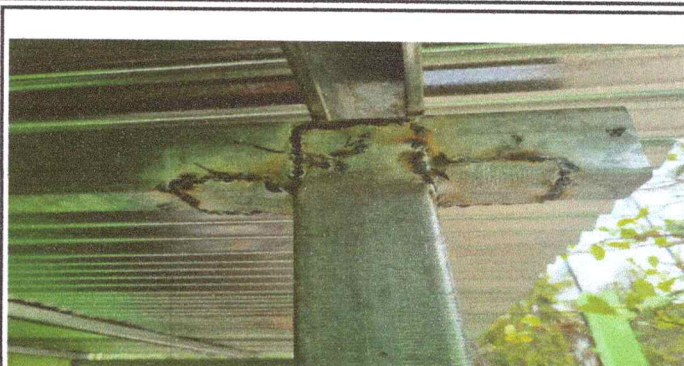
Foto 2: LA ESTRUCTURA EXISTENTE SERA SUSTITUIDA Y ESTARA DISEÑADA POR UN SISTEMA DE TIJEAS CON COSTANERAS, MAS PEDESTALES TIPO COLUMNA RIGIDIZANTE EN EL MARCO.
