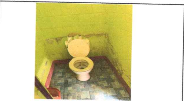
Foto 3: Cambio de Sanitarios y Lavamanos en mal estado.
