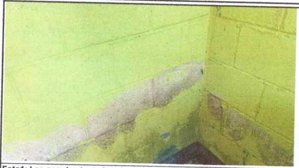
Foto 1: Las paredes tanto interiores como exteriores necesitan pintura.
