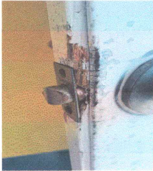
Foto 1: LAS PUERTAS ESTAN EN MAL ESTADO..
