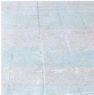
Foto 5: SE OBSERVA EL PISO ANTIGUO Y EN MAL ESTADO.
