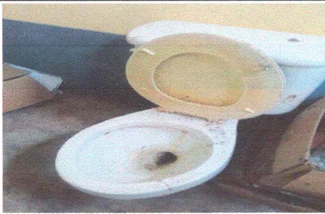
Foto 3: LOS SANITARIOS SON ANTIGUOS Y ESTAN EN MAL ESTADO.
