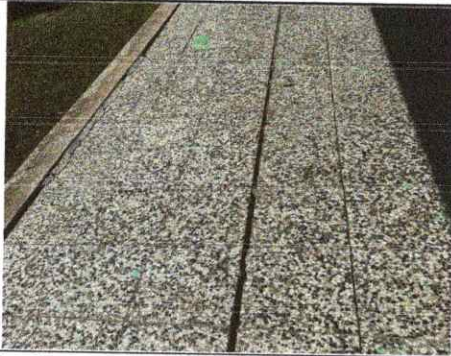
Foto1: Piso de corredor en malas condiciones.
