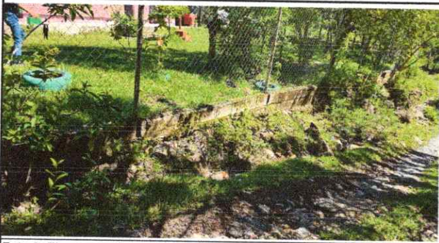
Foto 3: El cerco perimetral de malla está por caer.
