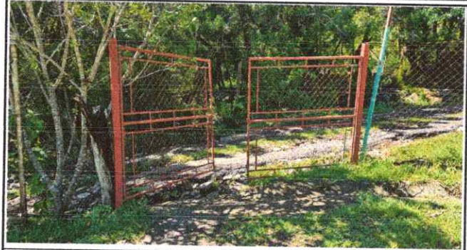
Foto 2: Porton en la entrada a la escuela en malas condiciones.
