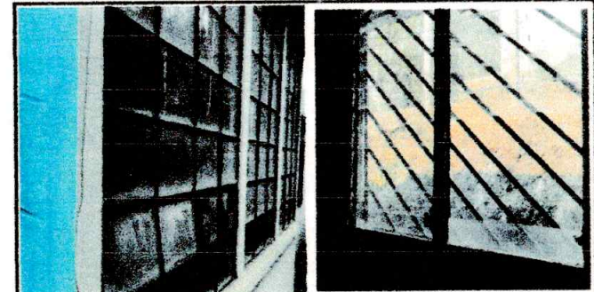
FOTO NO. 6 SE EVIDENCIAN VIDRIOS ROTOS.
