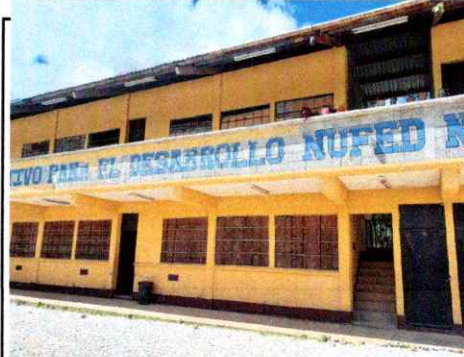
Foto 4: FALTA DE PINTURA, Y/O COLOR ADECUADO
