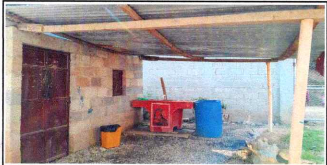
Foto 5: TECHO DE COCINA EN MAL ESTADO Y EN RIESGO DE COLAPSO
